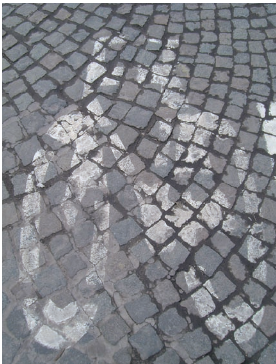
Illisibilité et usure d'un logo en peinture sur un revêtement modulaire
