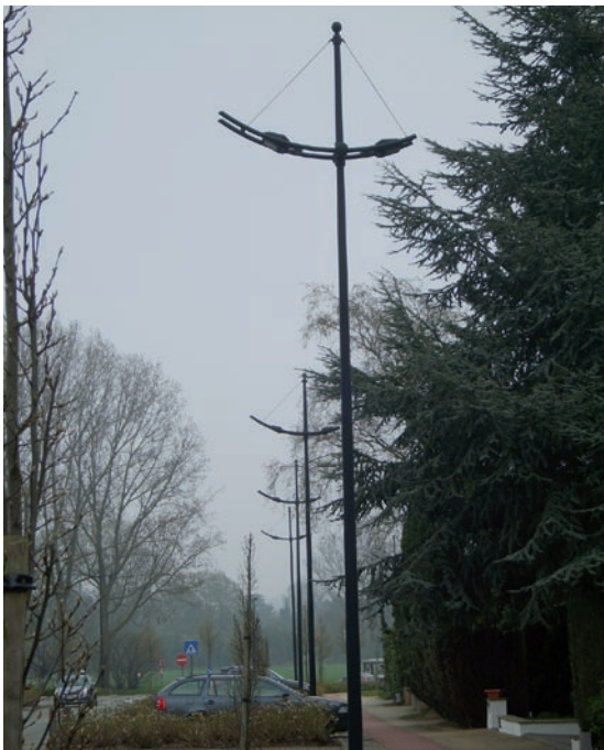
Système à deux luminaires: un pour la piste cyclable et un pour la chaussée
