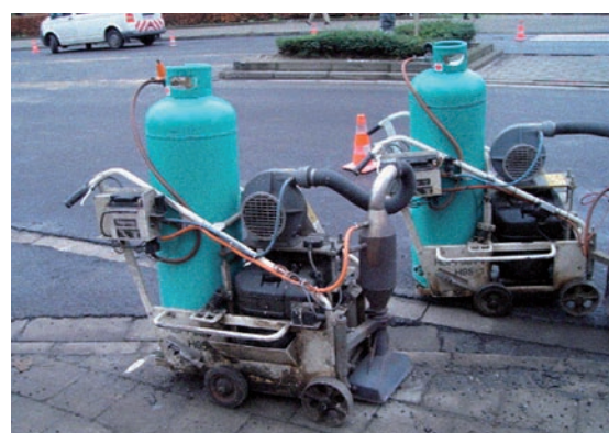
Équipement pour le séchage du revêtement à marquer
