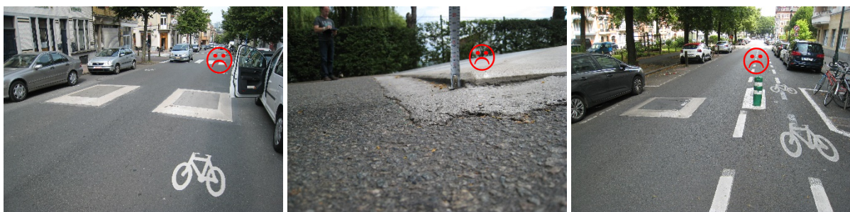
Afbeelding 14: Illustratie van enkele inrichtingen van het type rijbaankussens die een negatieve impact op de veiligheid van de fietsers kunnen hebben
