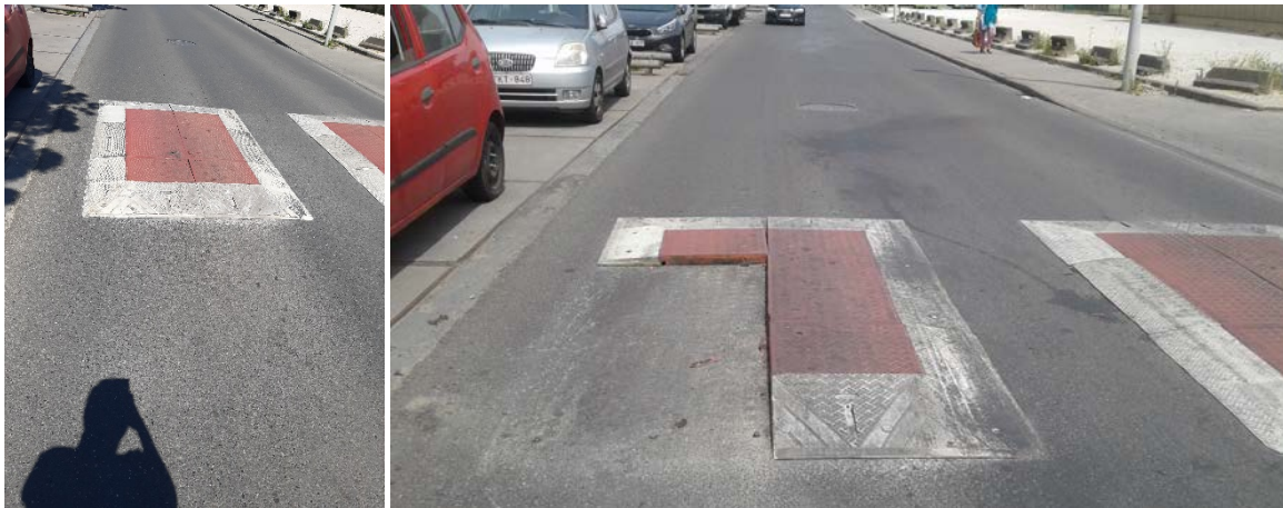
Afbeelding 109: Illustratie van losgekomen onderdelen van rubberen rijbaankussens (Nijverheidskaai in Anderlecht, foto's genomen op 14 mei 2020 en 4 juni 2020, aanleg in 2018). In dit geval is de breedte van de rijweg te beperkt om de regels betreffende de transversale positionering te kunnen naleven. Dit kan een impact hebben op de belasting die op de kussens wordt uitgeoefend.
