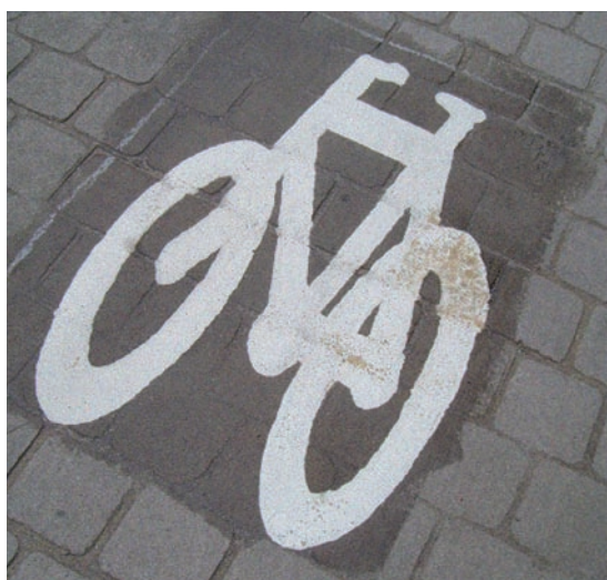
Dit voorgevormde fietslogo werd na de aanbrenging van een "primer" warm gekleefd op gefigureerd beton. Gefigureerd beton heeft minder diepe voegen, zodat de markering op dit soort van ondergrond duurzamer is
