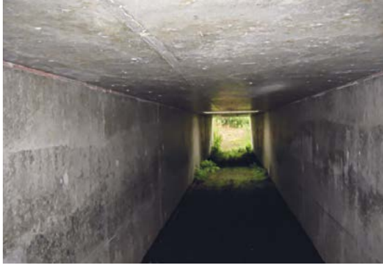
Figuur 71 – Voorbeeld van een tunnel (voor grote dieren) onder de infrastructuur. De tunnel op de foto heeft halverwege een gat. Hierdoor is het minder donker en lijkt de tunnel minder lang. Hij is daardoor, ondanks zijn lengte toch geschikt voor reeën en wilde zwijnen.
